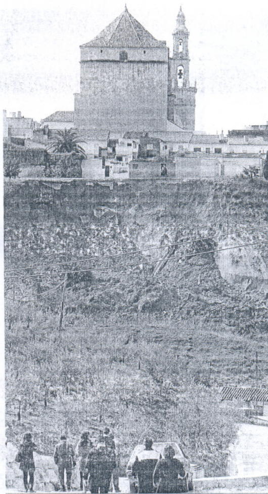
El derrumbe de una ladera destruye un paseo en Santaella (Córdoba). SALAS / EFE
