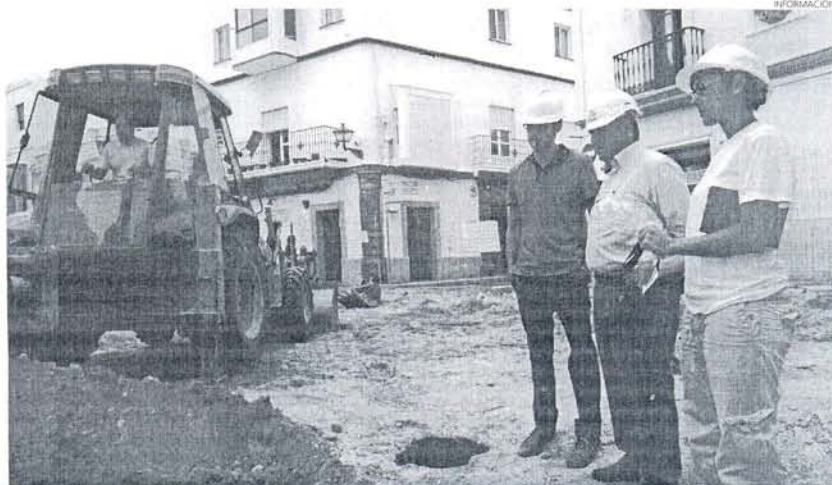
Las obras de esta plaza cambiarán totalmente su fisonomía y harán de la zona más agradable para el paseo.
