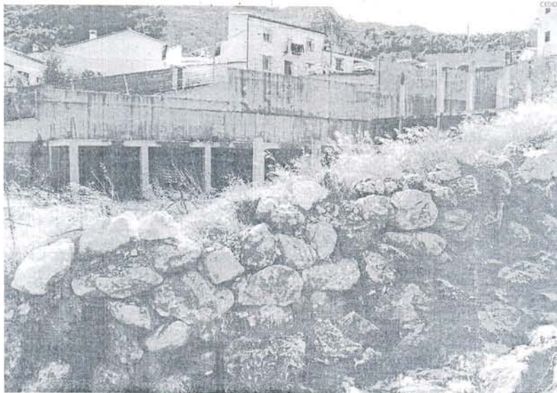
Imagen actual del edificio tras demolerse parte de él a causa de una sentencia judicial tras una denuncia de EA.
