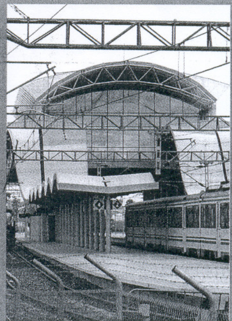
Desdoble de la vía del ferrocarril. Aunque ha habido avances, la llegada del AVE sigue aplazándose una y otra vez. En teoría faltan tres años.
