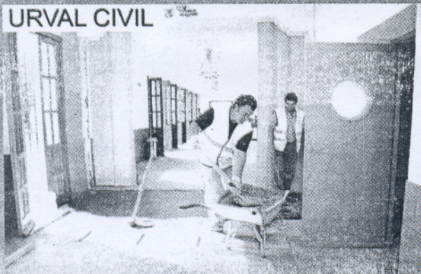
PROYECTO DE REFORMA DEL MANATORIO MUNICIPAL Y CENTRO DE TRANSFORMACION (CONSTRUCCIONES URVAL CIVIL)
