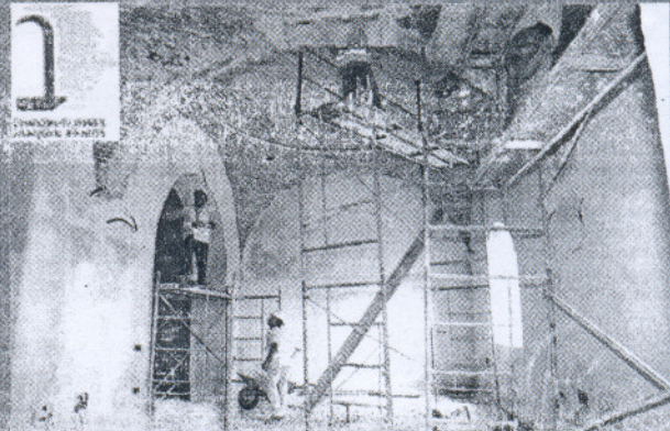
PROYECTO DE RESTAURACIÓN DE LA TORRE DE LA MERCED (CONSTRUCCIONES JOAQUÍN RAMOS)
