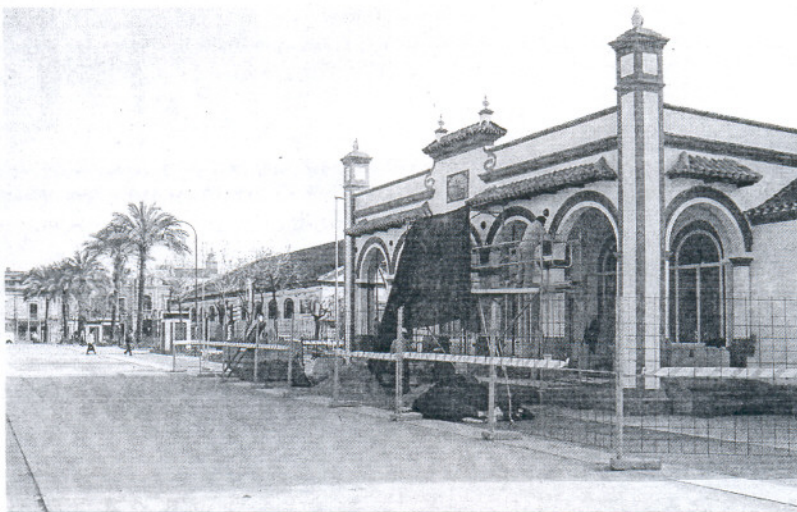
La Oficina Municipal de Turismo de Sanlúcar, radicada en La Calzada, está siendo objeto de reformas.
