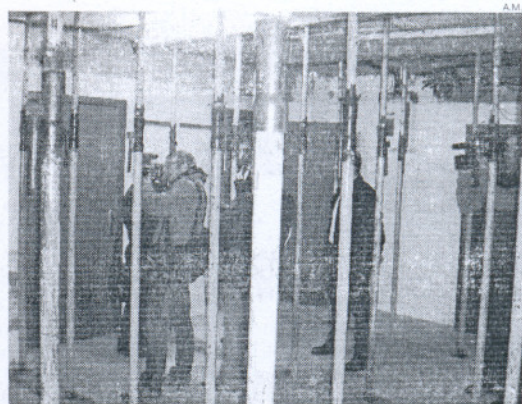
Los bajos del juzgado de guardia en Cádiz se encuentran apuntalados.
