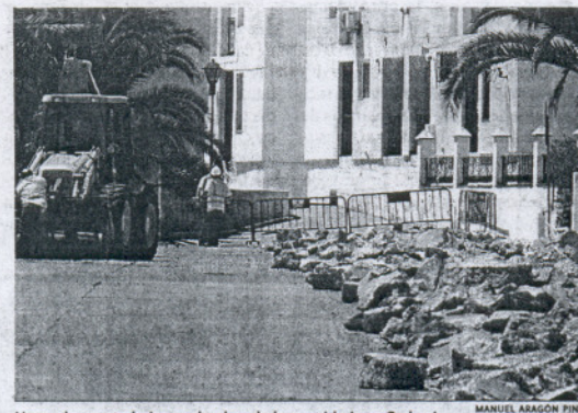
Unos obreros trabajan en la obra de la avenida Juan Carlos I. MANUEL ARAGÓN PÉREZ
